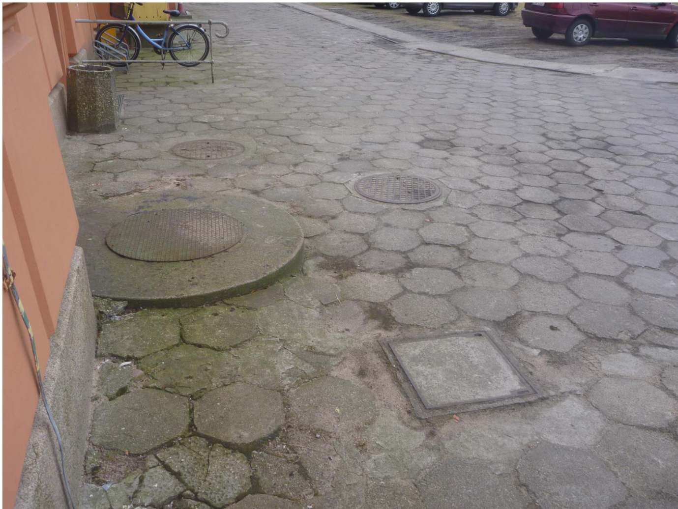
Fot. 13 Droga wewnętrzna – miejsce przejścia kabla zasilającego w rurze osłonowej
