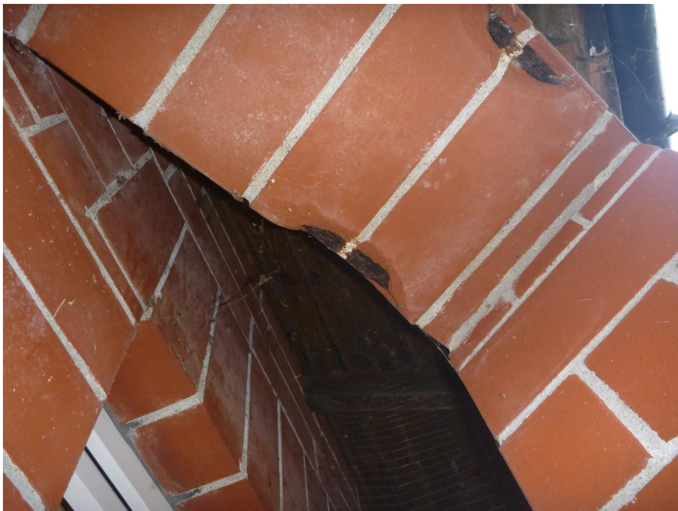
Fot. 13 Odspojenia okładziny zewnętrznej na ryglu
