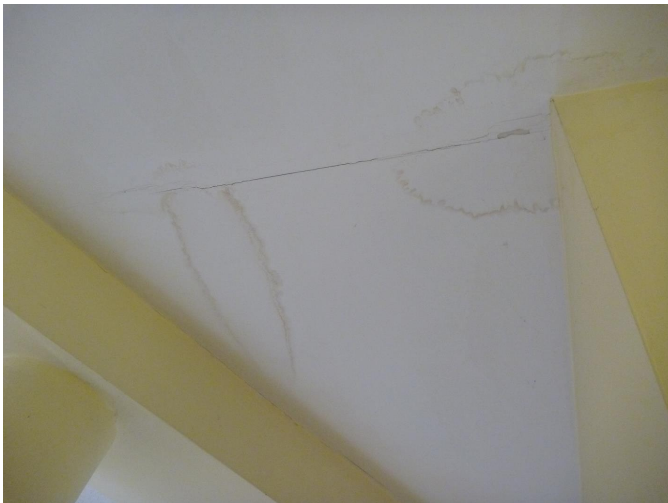
Fot. 25 Budynek byłego MPG. Korytarz główny – zacieki na suficie
