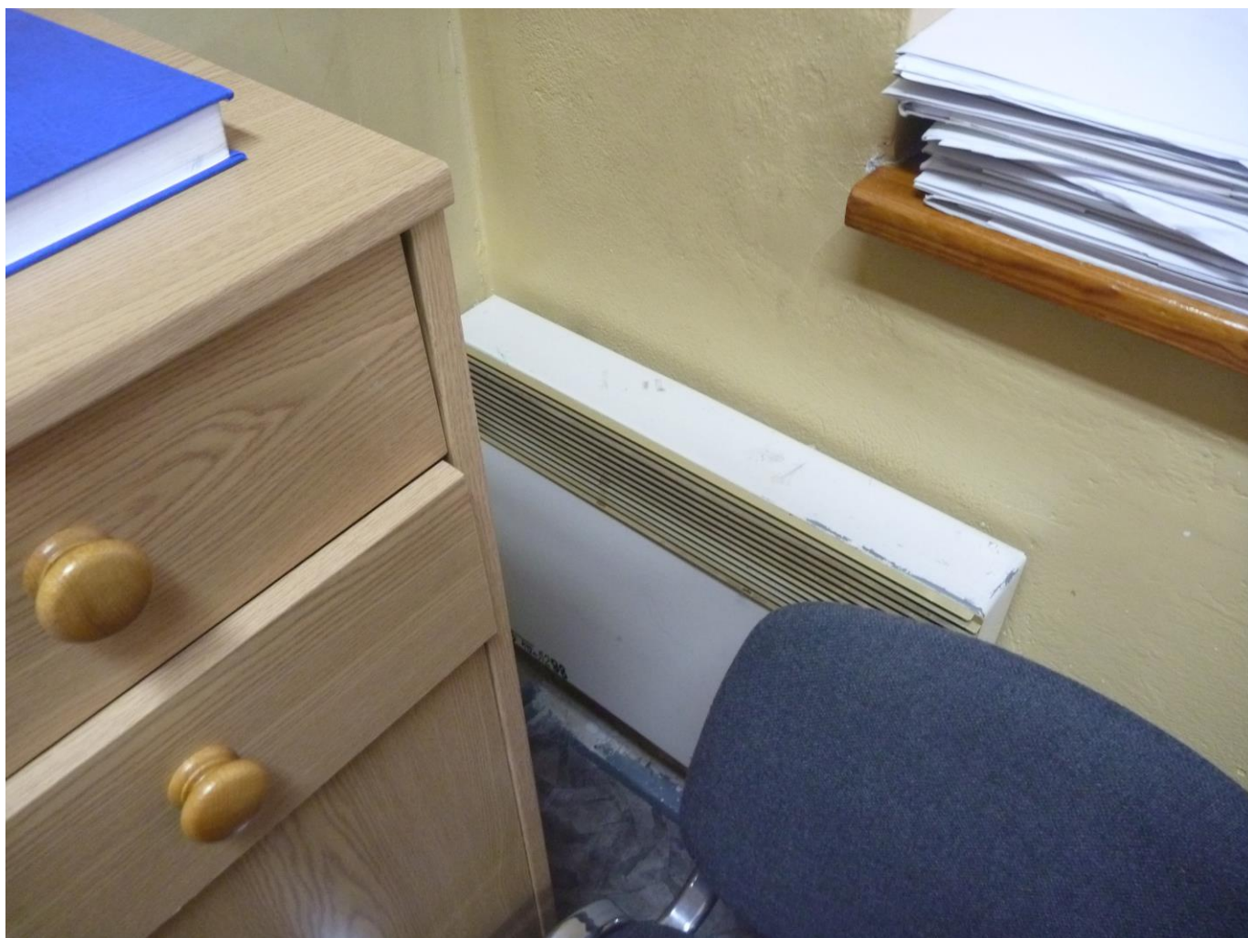
Fot. 39 Budynek byłego MPG. Bosmanat - grzejnik
