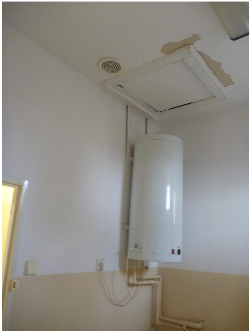
Fot. 46 Budynek byłego MPG. Zasobnik wody. Uszkodzony wylaz na stropodach.
