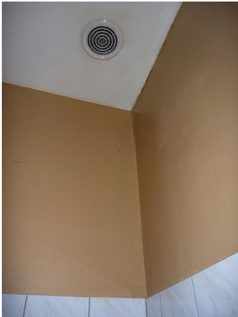
Fot. 48 Budynek byłego MPG. Pęknięta ściana w WC
