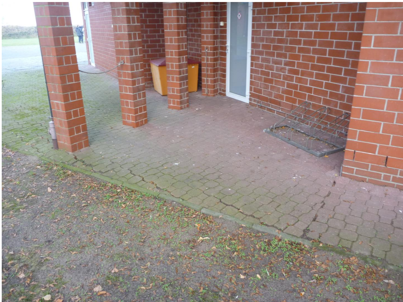
Fot. 08 Osiadająca opaska i chodniki wokół budynku
