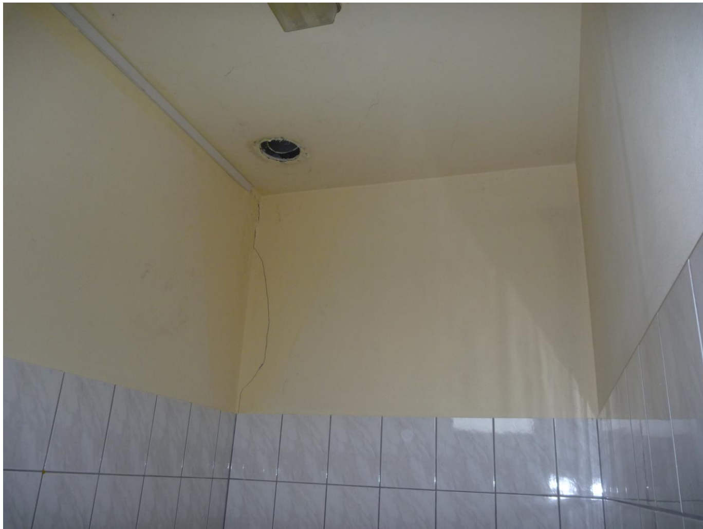
Fot. 44 Budynek byłego MPG. Pęknięta ściana w WC
