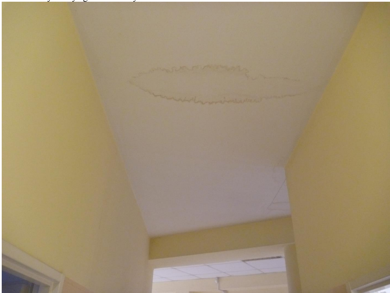
Fot. 27 Budynek byłego MPG. Korytarz nr 2 – zacieki na suficie
