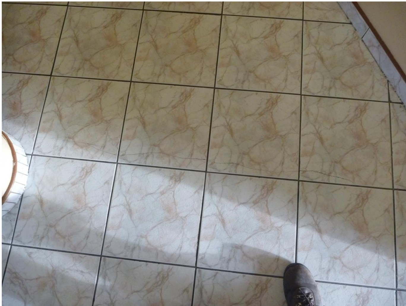
Fot. 24 Budynek byłego MPG. Korytarz główny – pęknięte okładziny posadzkowe
