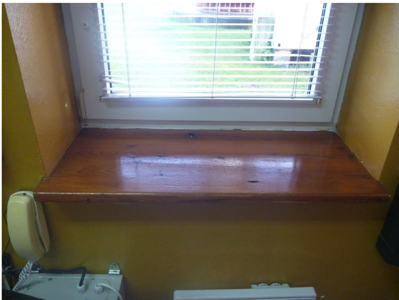
Fot. 31 Budynek byłego MPG. Pomieszczenia bosmanatu – stare parapety
