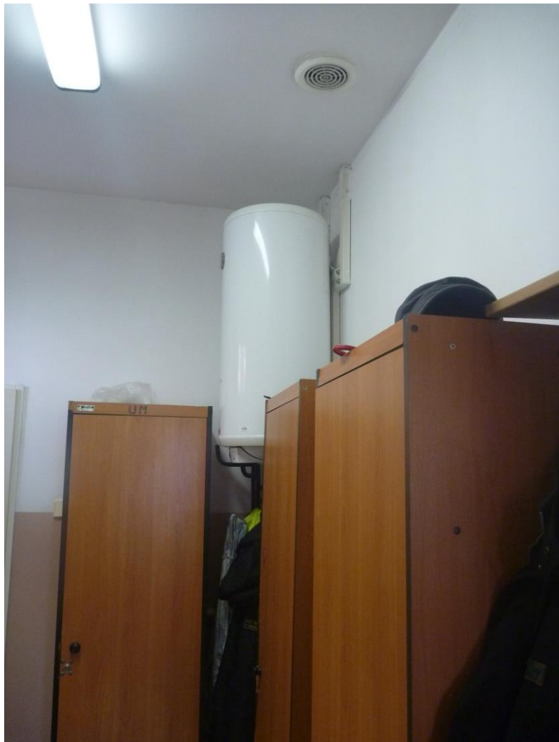
Fot. 32 Budynek byłego MPG. Pomieszczenia bosmanatu – zasobnik ciepłej wody
