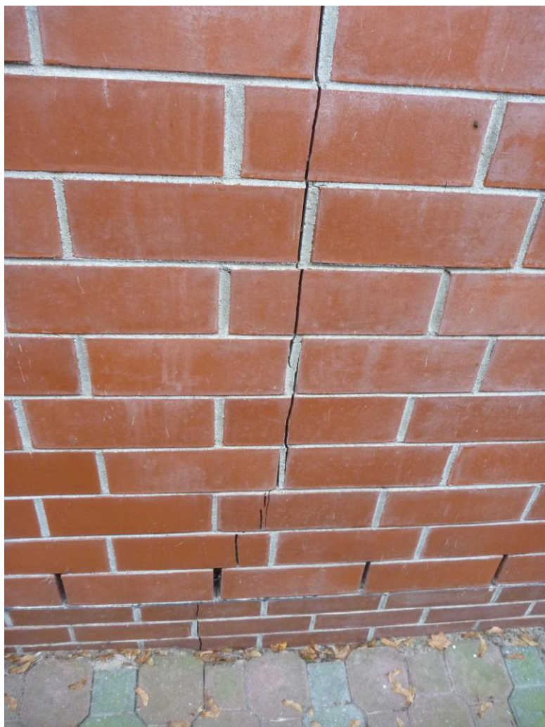
Fot. 11 Pęknięcie na elewacji wschodniej
