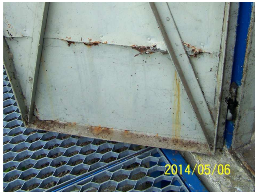
Fot . 35 Korozja drzwi stalowych
