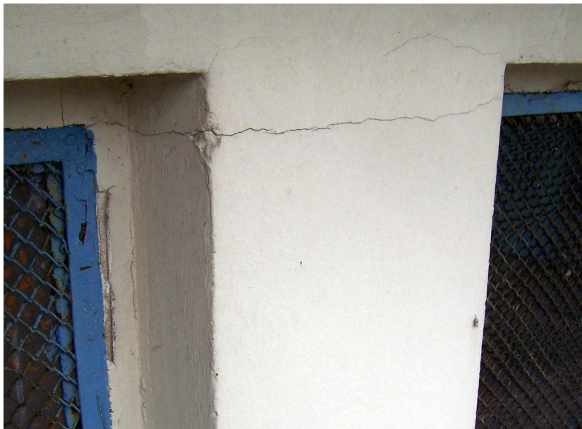
Fot . 17 Ściana południowa – Uszkodzenie filarków międzyokiennych
