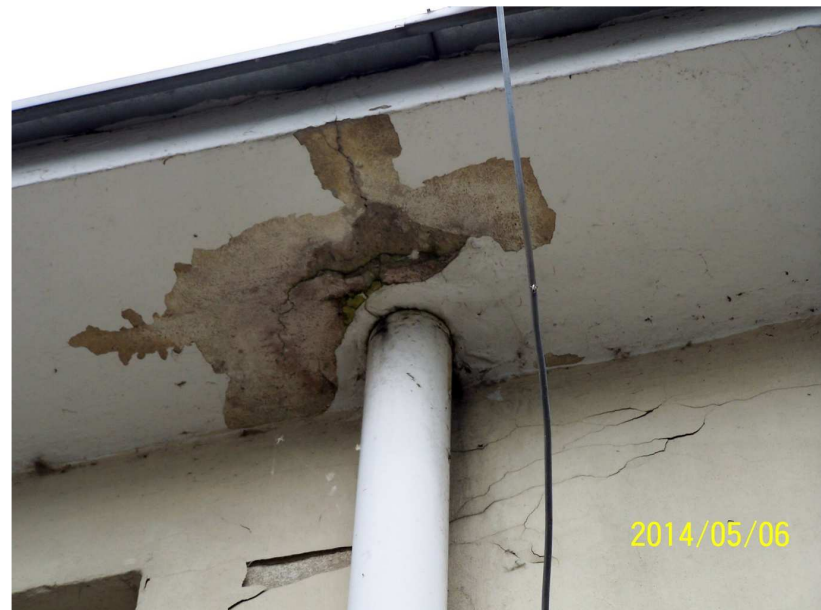
Fot . 15 Ściana południowa – Uszkodzenie gzymsu
