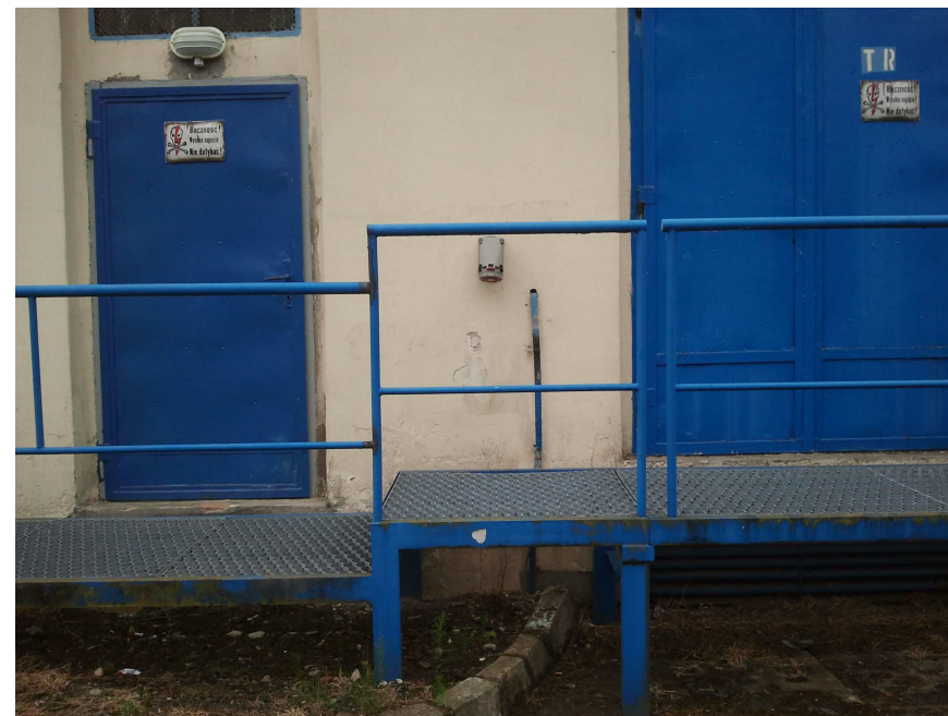
Fot . 48 Północna ściana budynku – gniazdo do przyłączenia agregatu
