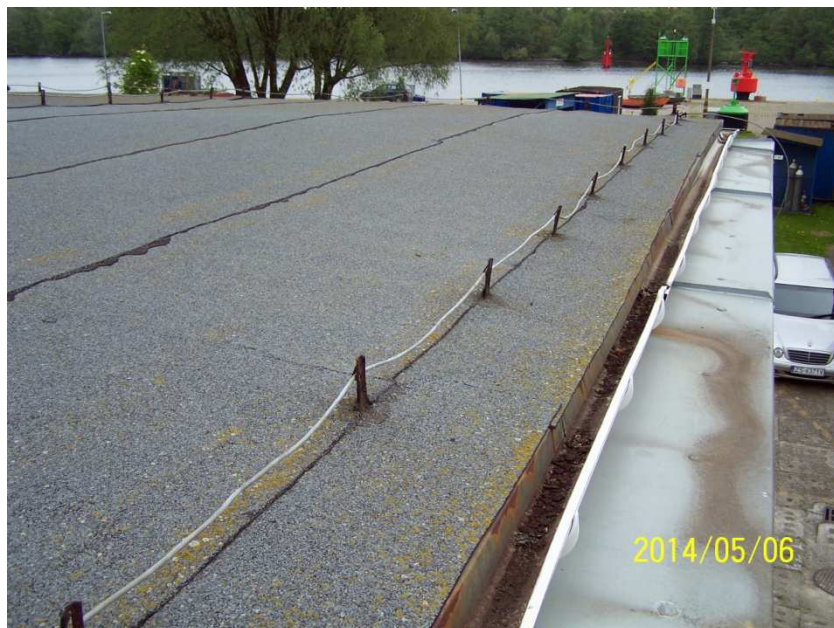
Fot . 29 Dach – Korozja okapu nadrynnowego, zacieki okapu gzymsu
