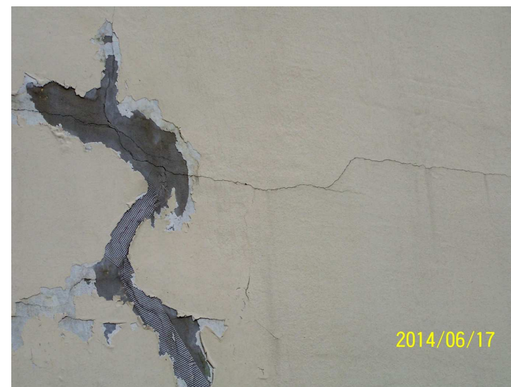
Fot . 08 Rysa w ścianie południowej – Ślady nieudanej naprawy
