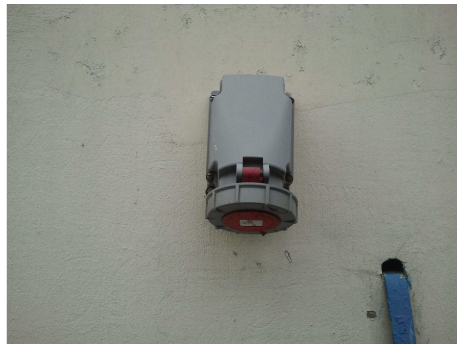
Fot . 49 Północna ściana budynku – gniazdo do przyłączenia agregatu
