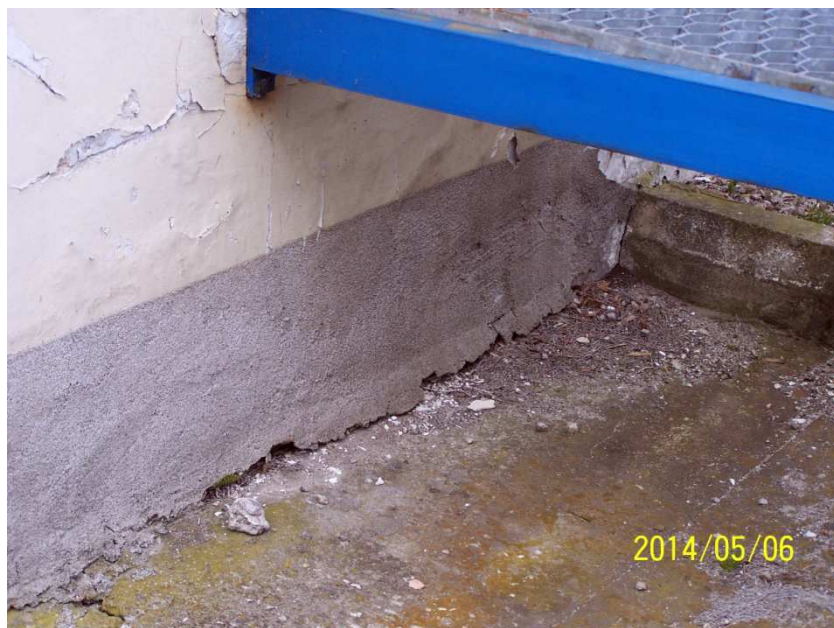
Fot . 22 Ściana wschodnia – Uszkodzenie cokołu, poziome rysy ściany
