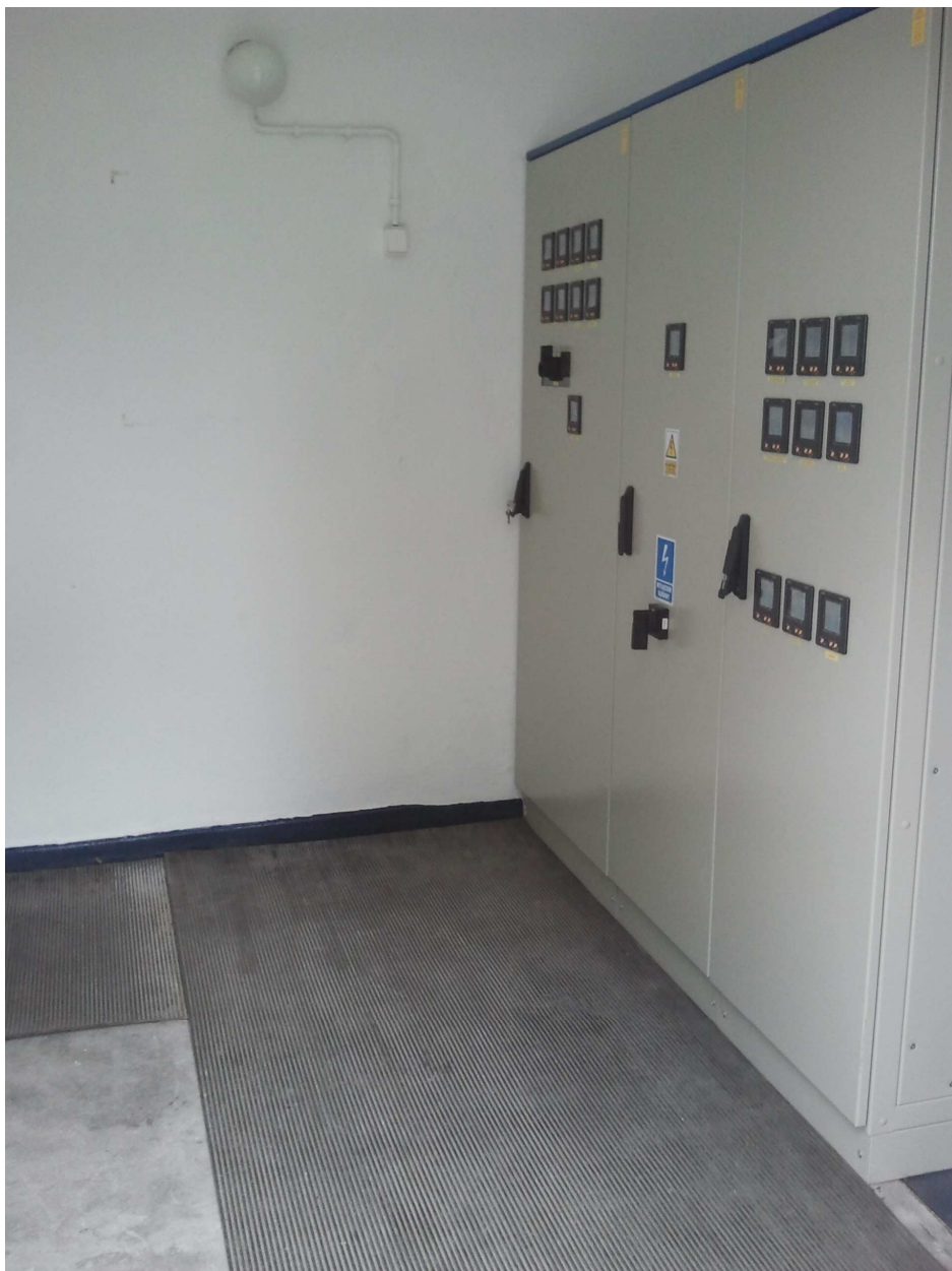
Fot . 47 Pomieszczenie Nr 3 NN – widok ogólny
