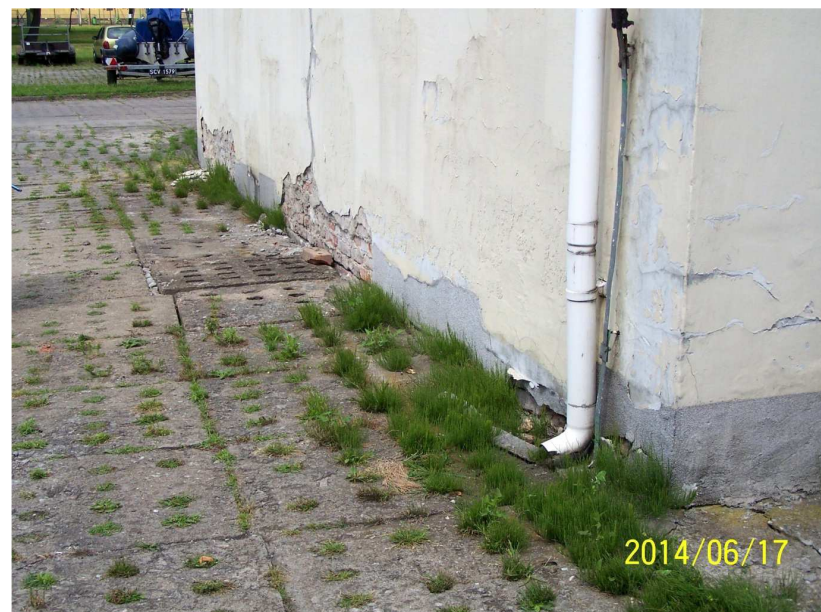
Fot . 16 Ściana południowa – Uszkodzenie tynku w strefie cokołowej
