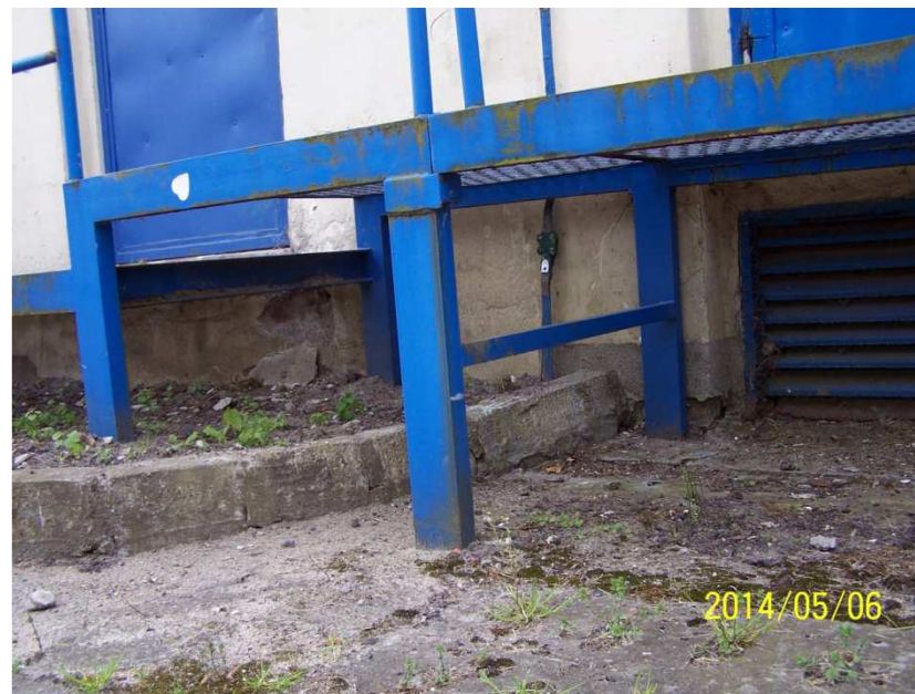
Fot . 28 Ściana północna – Strefa cokołowa – Skutek zawilgocenia ściany
