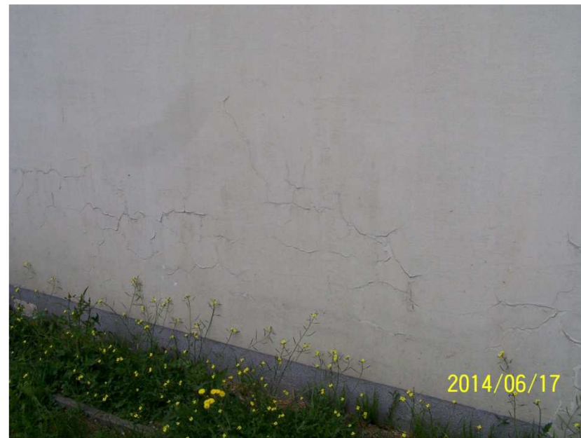
Fot . 23 Ściana wschodnia – Uszkodzenie cokołu, poziome rysy ściany
