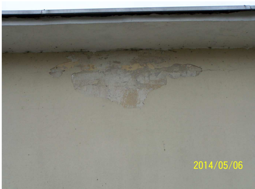
Fot . 21 Ściana wschodnia – Zaciek i zarysowanie ściany pod gzymsem
