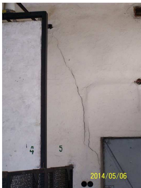
Fot . 38 Pomieszczenie Nr 1 SN – Pęknięcie ściany wschodniej
