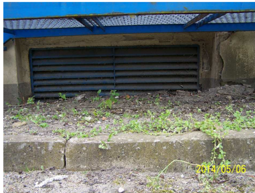
Fot . 27 Ściana północna – Strefa cokołowa – Skutek zawilgocenia ściany
