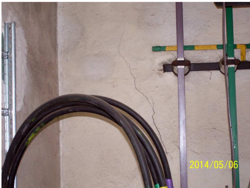
Fot . 41 Pomieszczenie Nr 2 TR – Rysa w ścianie podłużnej wewnętrznej
