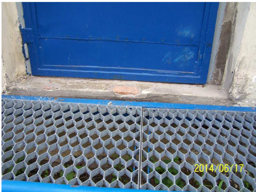
Fot . 33 Uszkodzenie posadzki w progu
