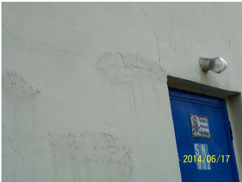
Fot . 18 Ściana zachodnia – Zarysowanie ściany, pęknięcie nadproża, ślady naprawy rys
