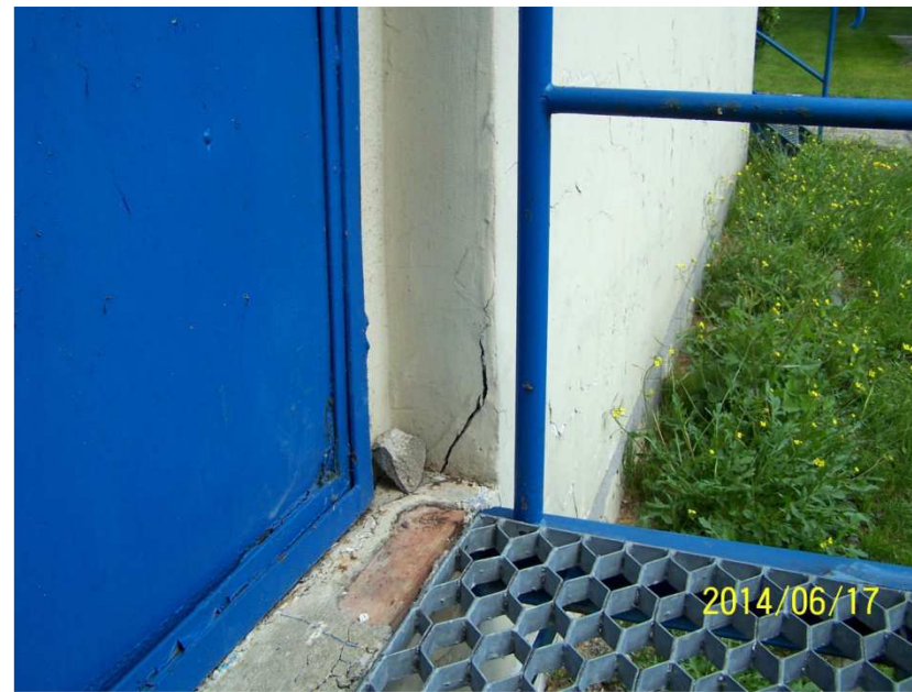
Fot . 32 Uszkodzenie posadzki w progu
