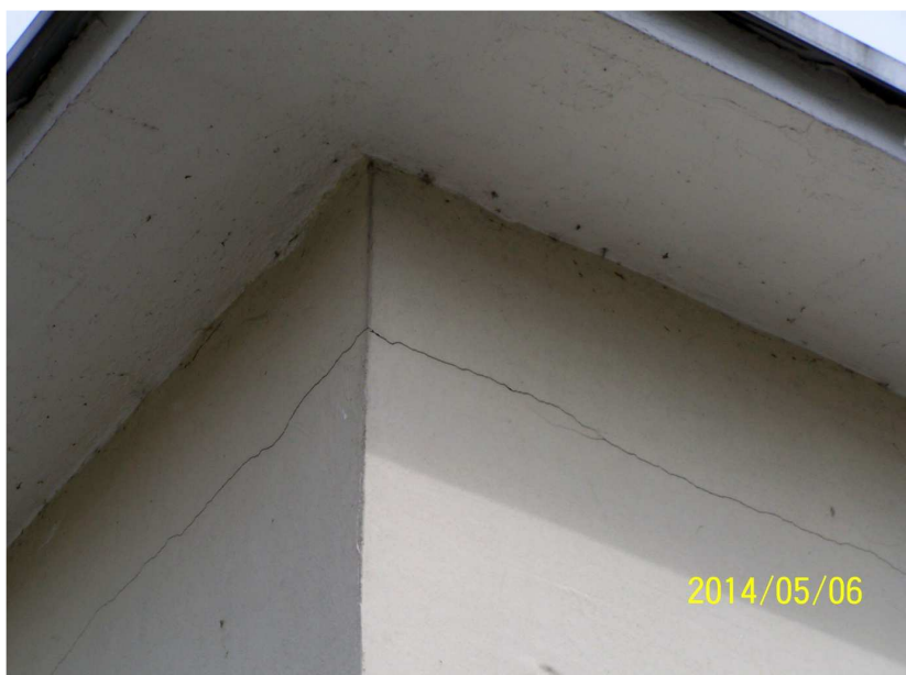
Fot . 14 Narożnik południowo-zachodni – Rysa pozioma
