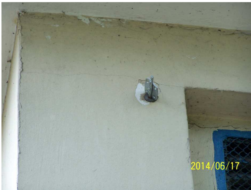
Fot . 26 Ściana północna – Zaciek pod gzymsem, rysa pozioma ściany
