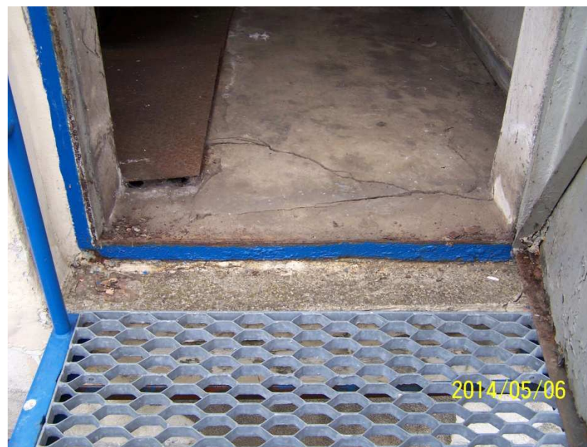
Fot . 40 Pomieszczenie Nr 1 SN – Pęknięcie posadzki, korozja ościeżnicy i płyt stalowych
