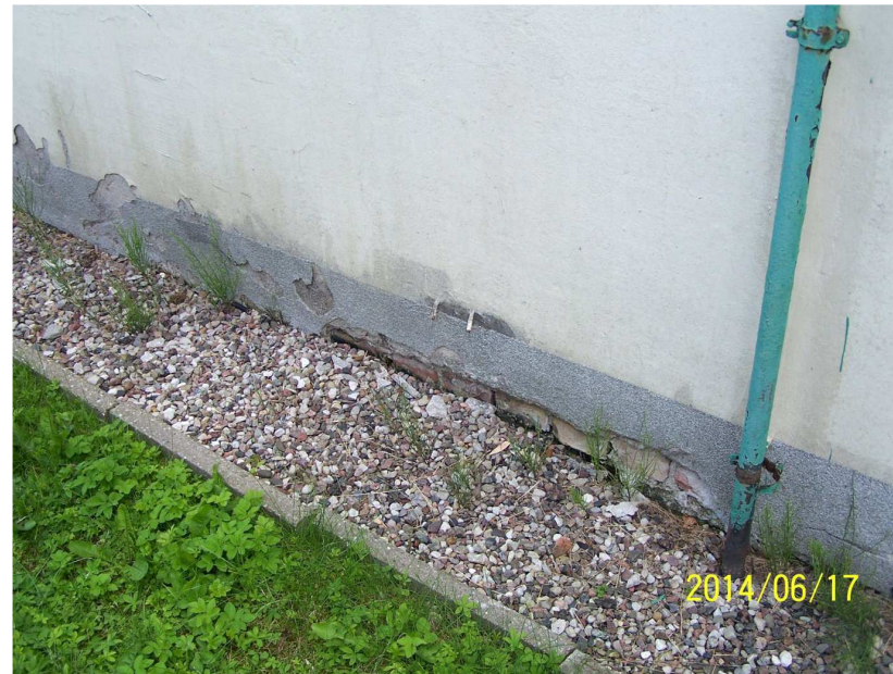
Fot . 19 Ściana zachodnia – Odpadający tynk w strefie cokołowej
