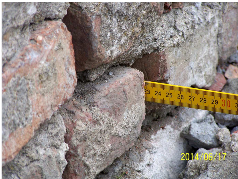
Fot . 13 Rysa w ścianie południowej – Dolna strefa rozwarstwienia ściany
