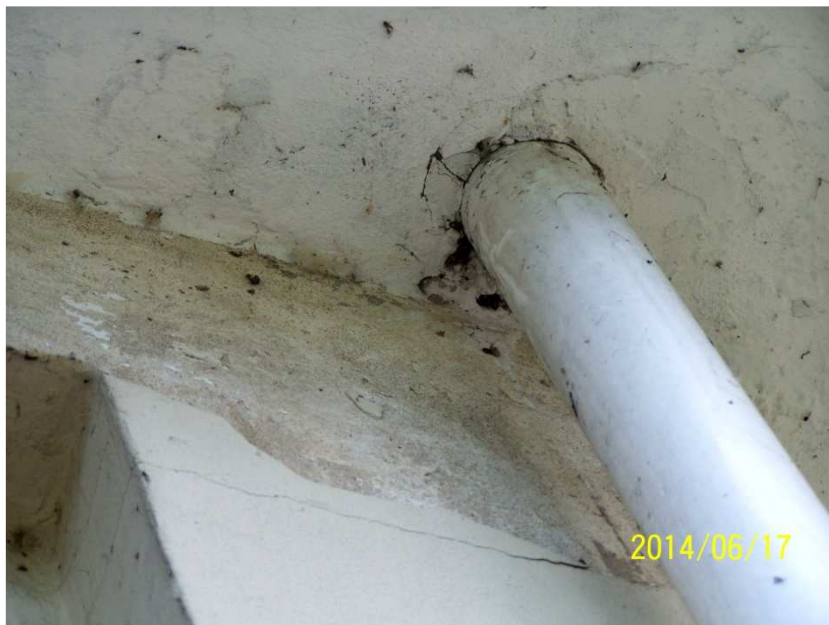
Fot . 25 Ściana północna – Zaciek pod gzymsem, rysa pozioma ściany
