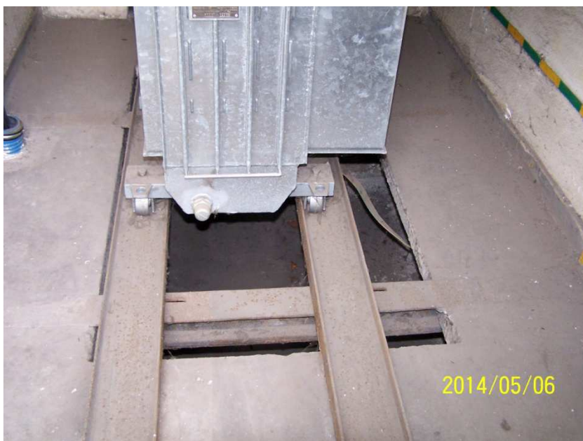
Fot . 42 Pomieszczenie Nr 2 TR – Korozja elementów stalowych
