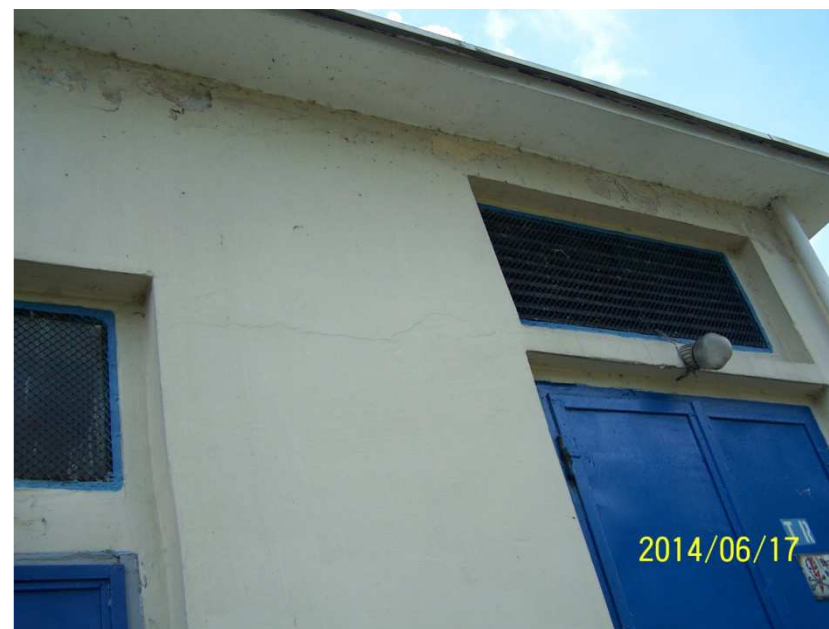
Fot . 24 Ściana północna – Zaciek pod gzymsem, rysa pozioma ściany
