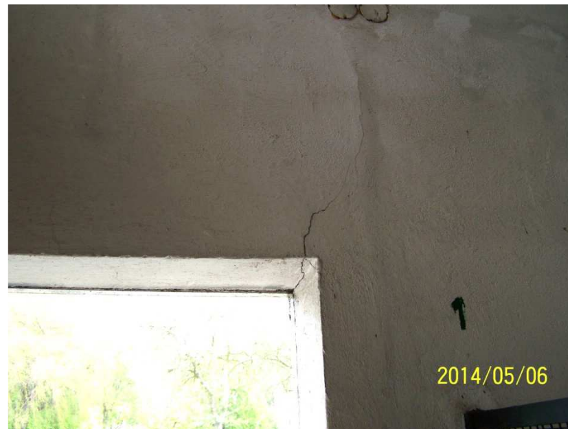
Fot . 39 Pomieszczenie Nr 1 SN – Pęknięcie ściany zachodniej
