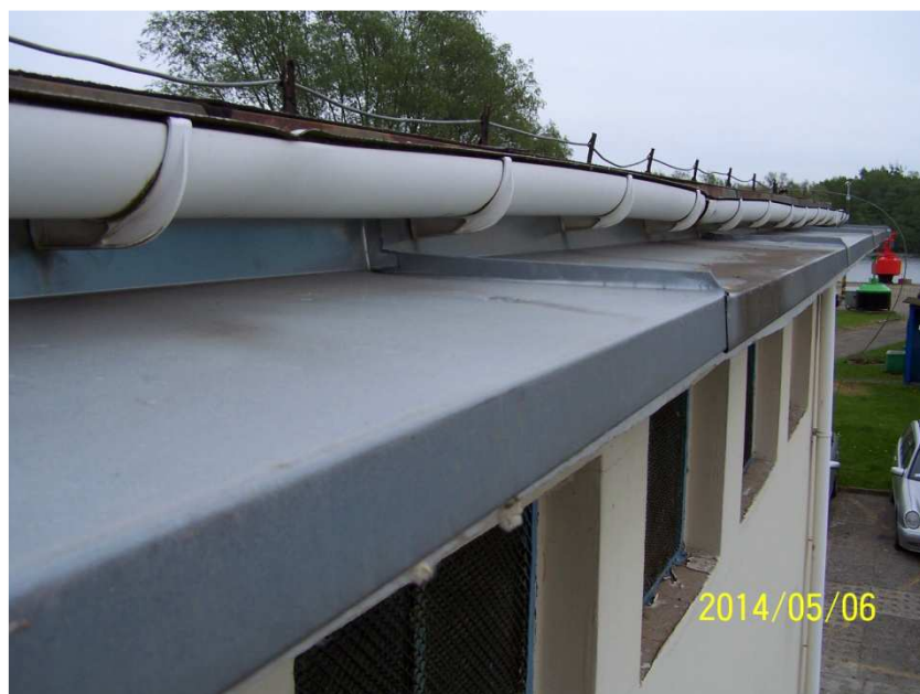
Fot . 30 Dach – Nieszczelności łączenia rynny, zacieki okapu gzymsu
