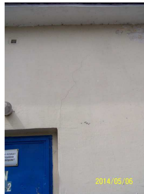
Fot . 20 Ściana wschodnia– Zarysowanie ściany i nadproża
