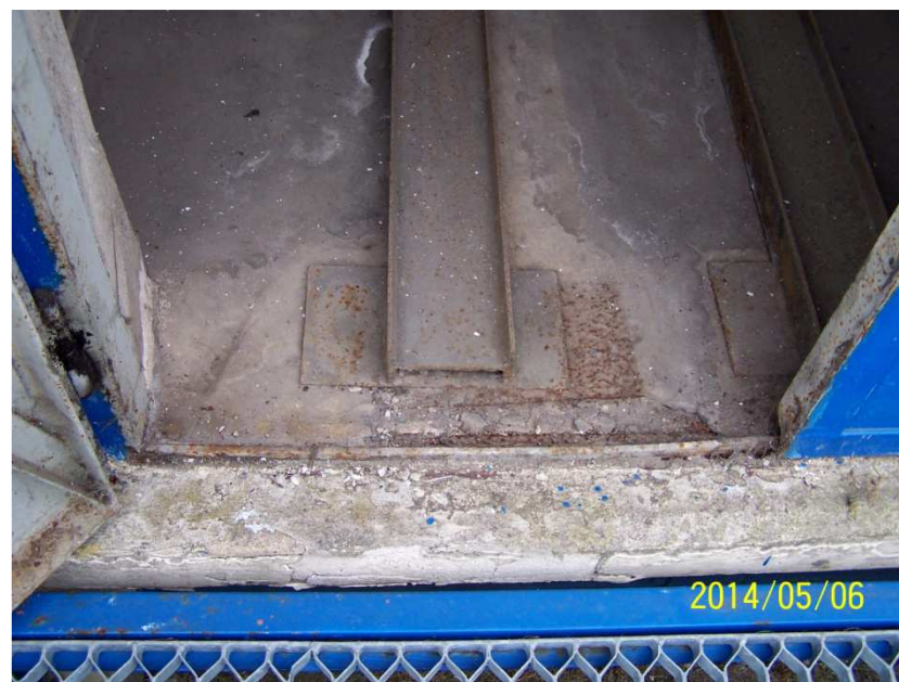
Fot . 36 Korozja ościeżnicy oraz innych elementów stalowych
