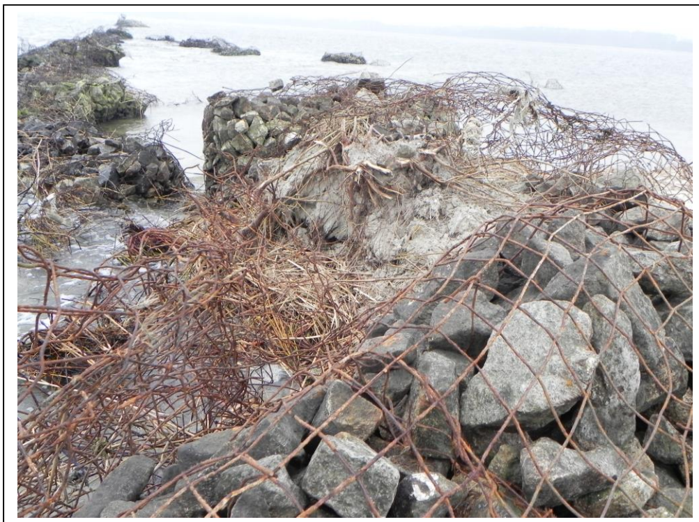
Fot. 3 II typ zniszczenia
